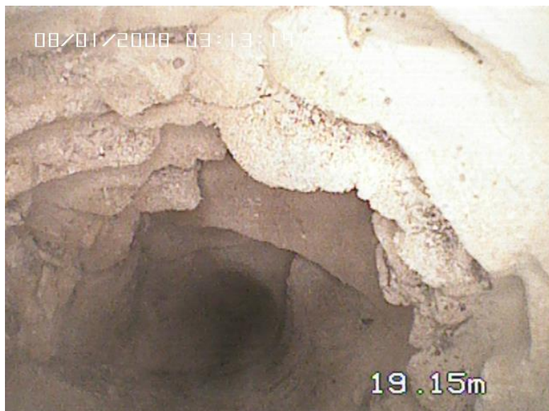
Abbildung 2: Stark aufgelockerter/zerrütteter Kalkfels. Die mit Bohrmaterial bedeckten anstehenden Steine und Blöcke sind z.T. lose.
