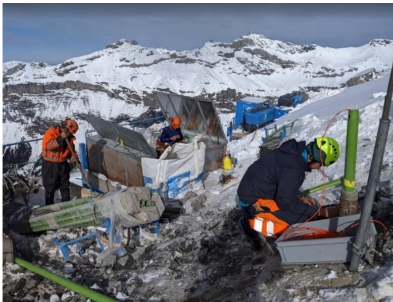
Abbildung 9: Inclinometermessung bei TB 1. Ursprünglich waren Messungen über 60 m geplant, um Verschiebungen entlang der mutmasslichen Hauptgleitfläche zu bestimmen. Das Inclinometerrohr konnte jedoch nur bis in 26 m Tiefe abgeteuft werden.
