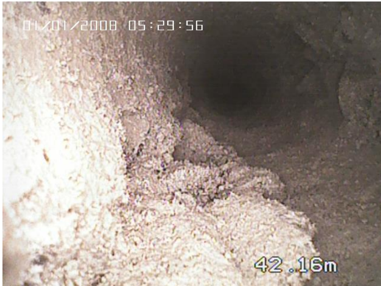
Abbildung 13: Weiches und feuchtes Mergelsubstrat, rasch nachbrechend.
