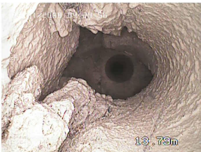
Abbildung 16: Vertikale Kluft. Das auf der Bohrlochwand abgelagerte Material ist in diesem Abschnitt vernässt.
