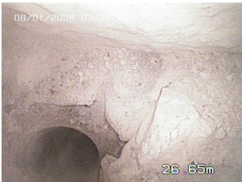
Abbildung 6: Grosse Kluft im Kalksteinbereich. Die Kluft lenkte den Bohrer so weit ab, dass das Bohrloch mit den Inklinometerrohren bzw. der Kamera nicht mehr erreicht wurde.
